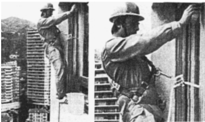
Figura 2 Esempio di posizione corretta su davanzale e di un utilizzo di apparecchio anticaduta su scala irrazionalmente appoggiata (a sinistra)
